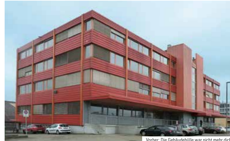
Vorher: Die Gebäudehülle war nicht mehr dicht
